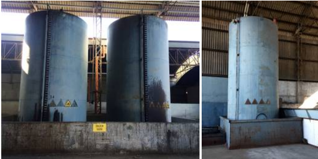
Serbatoi presenti nel capannone Area C
