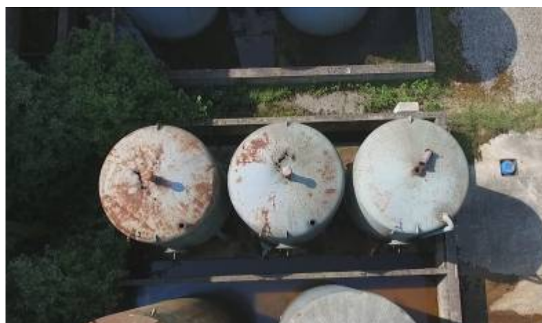
(bacino 41E serbatoi n. 27, 28 e 29)
