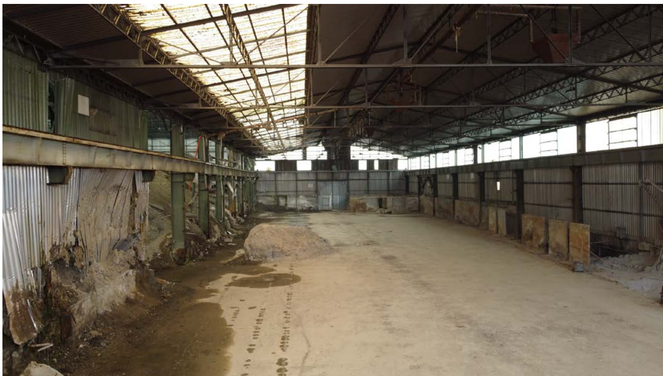
Figura 2: accumulo costituito da un conglomerato cementificato di rifiuti nel capannone 2
